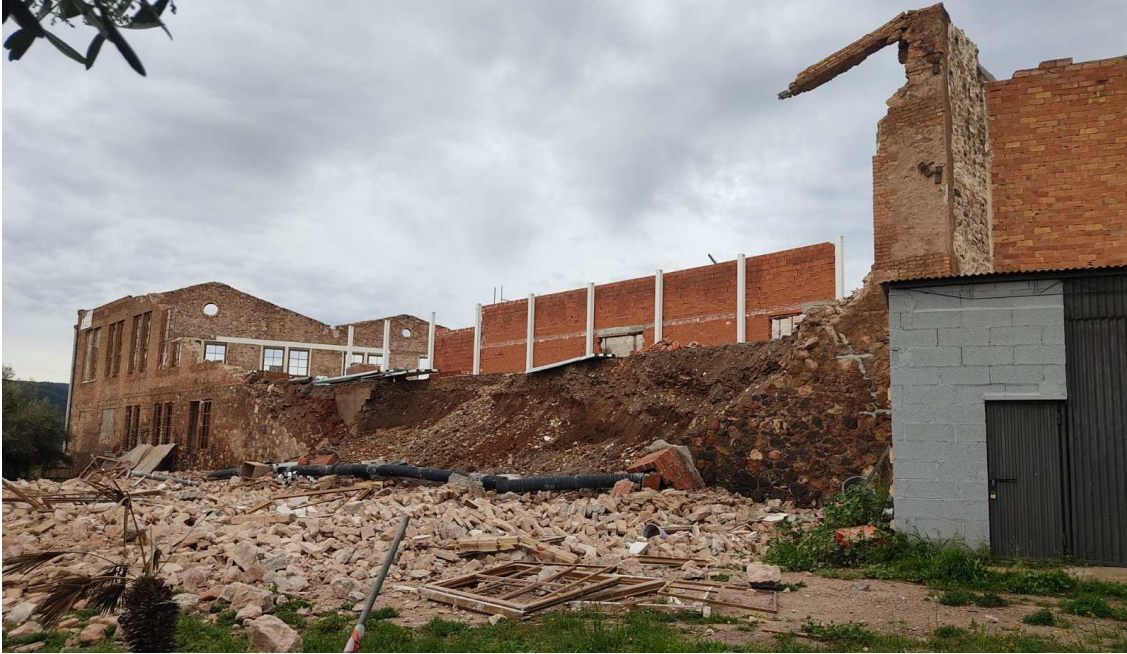
Derrumbe de la fachada, el muro de contención y las tierras
